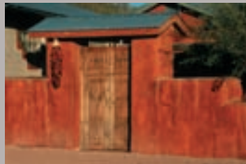
Mur en paille enduit de chaux avec un toit en métal au-dessus de l'entrée et une protection en tuiles plates sur le reste du mur. Patagonia, Arizona.
